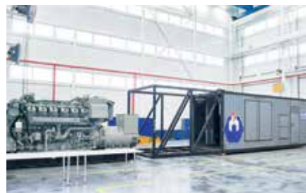
УЧАСТОК СБОРКИ (ПАКЕТИРОВАНИЯ) ГПЭС и ДРУГОГО ЭНЕРГООБОРУДОВАНИЯ
